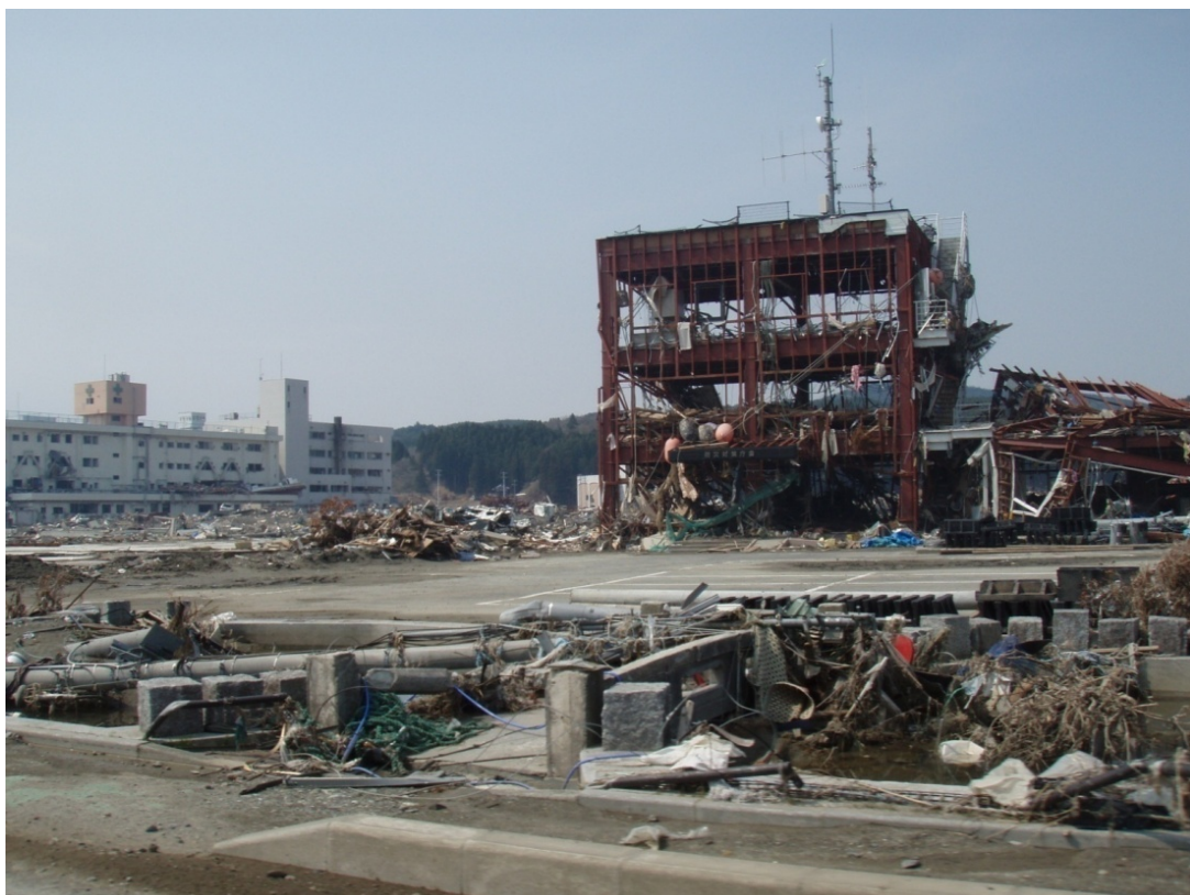
津波により骨組みだけとなった防犯庁舎(宮城県南三陸町)
