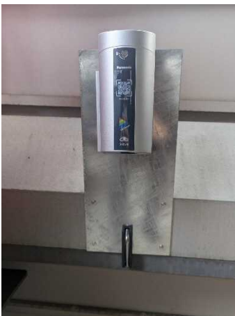
設置したEV充電設備
